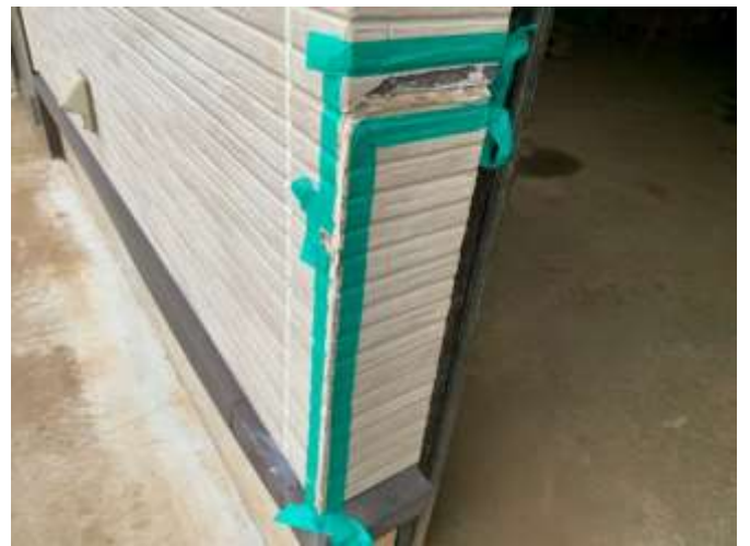
外壁破損部分
