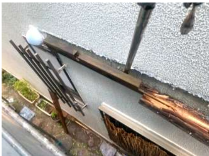
外壁破損部分
